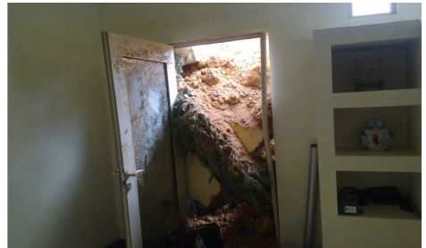
Fig 11. Deslave en Colonia Mesa de la Corona, Distrito San Ángel, municipio de San Pedro Garza García, N.L. Fuente: IMPLANG San Pedro Garza García.
